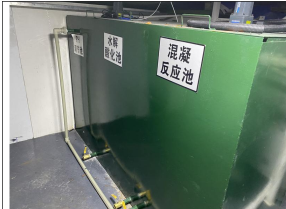
污水处理设施
